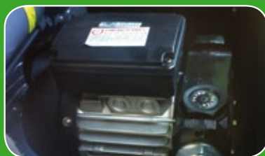
11 Топлиперекачивающий насос (автоматическое/ручное управление)
